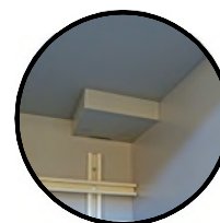
Orifices de ventilation avec thermofusible
