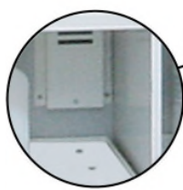
Orifice de ventilation avec thermofusible
