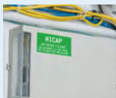
Etiquetage pour les tableaux de commande
